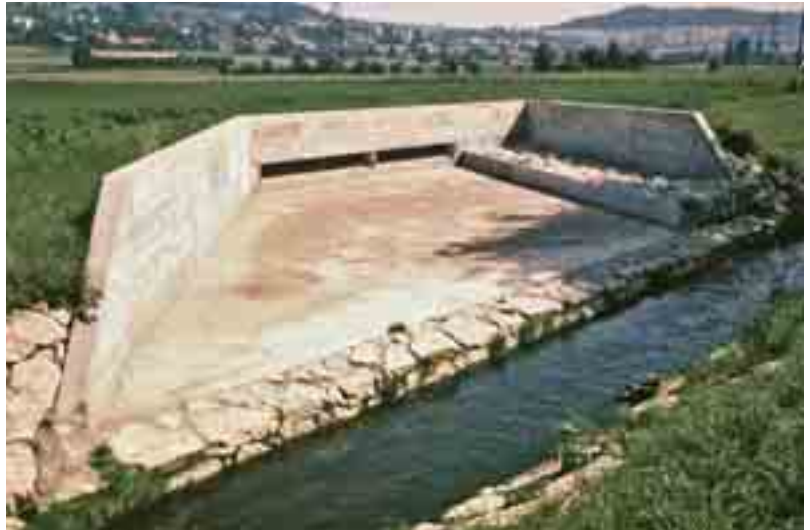
Grosse Mischwasserentlastungen, wie hier am Furtbach/ZH, können Gewässer stark beeinträchtigen.
